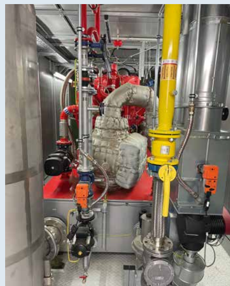
Das Herzstück der Anlage ist ein 8-Zylinder Gasmotor mit einem Generator.
