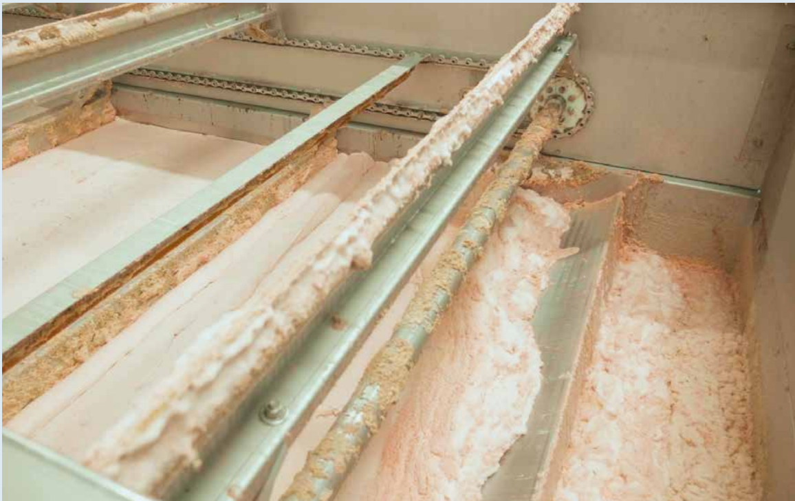
Seit 2019 gibt es schon die Aeco-Fat-Anlage bei Esbro, die durch die Fettrückgewinnung wertvolle Ressourcen erzeugt.
