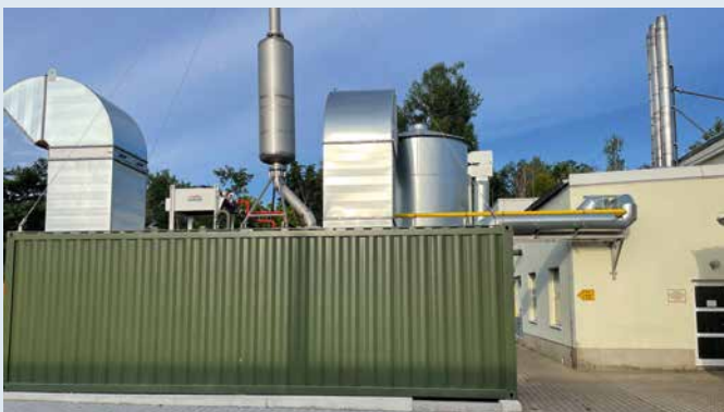
Das BHKW hat eine Gesamtfläche von 30 m 3 .
